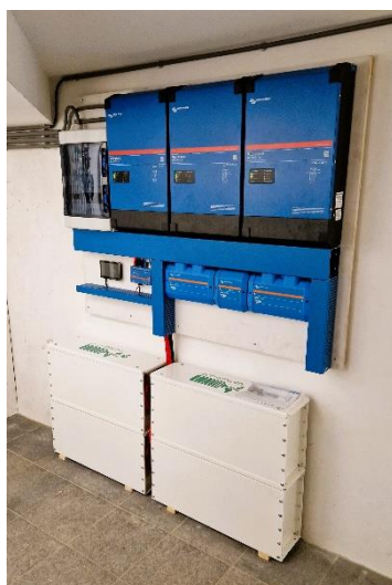
Figuur 6: 3x5KVA en 2x14kWh opslag. Geplaatst in kelder.
