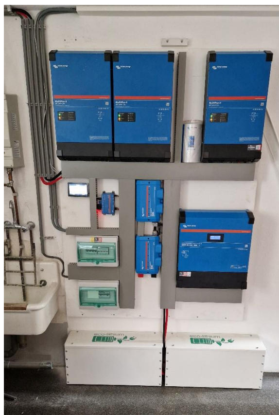
Figuur 9: 3x5kVA met MPPT lader, maatwerk opstelling in garage.
