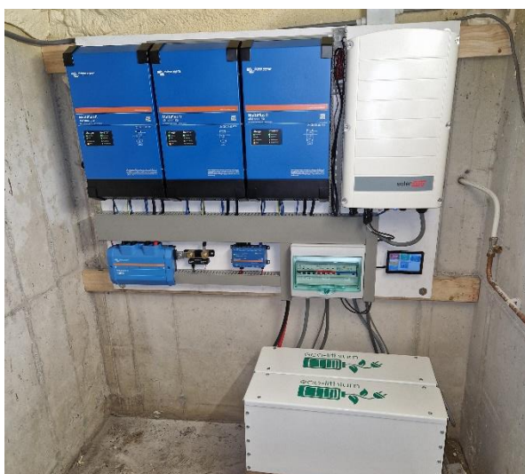
Figuur 11: 3x 3kVA, geïntegreerd met SolarEdge en 14kWh batterij
