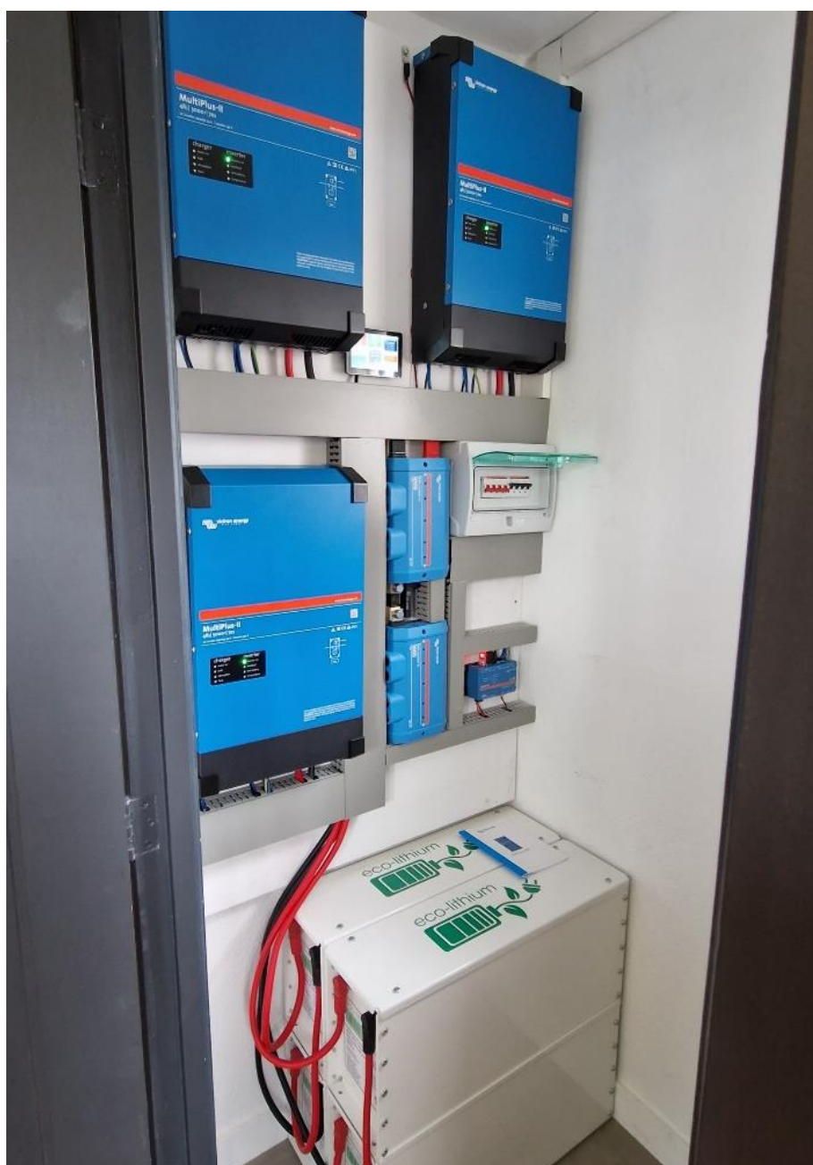
Figuur 4: een voormalige toiletruimte functioneert nu als energieopslag
